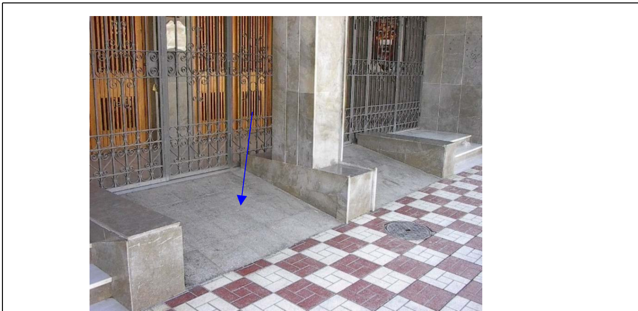
FOTO 2 | ENTRADA- RAMPAS INADECUADAS CON 20 % DE PENDIENTE- LAS REJAS ABREN HACIA FUERA OCUPANDO EL ÁMBITO DE LA RAMPA
