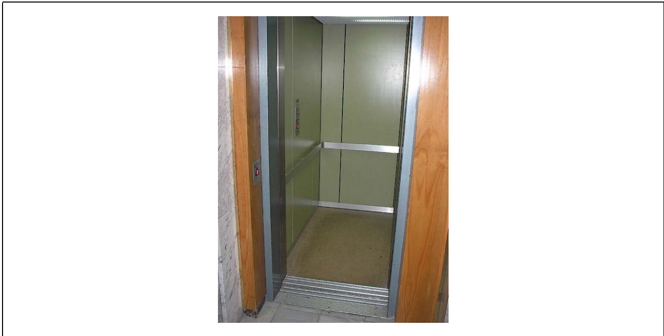
FOTO 3 | ASCENSOR- DESDE EL VESTÍBULO DE ENTRADA A LA PRIMERA PLANTA
