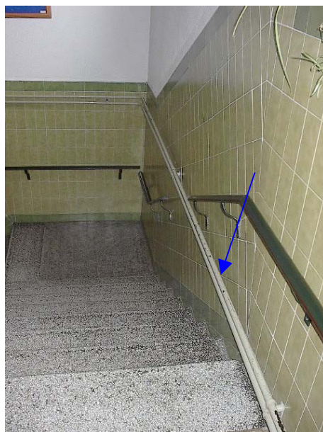
FOTO 7 | COLOCACIÓN PELIGROSA DE LA TUBERÍA
