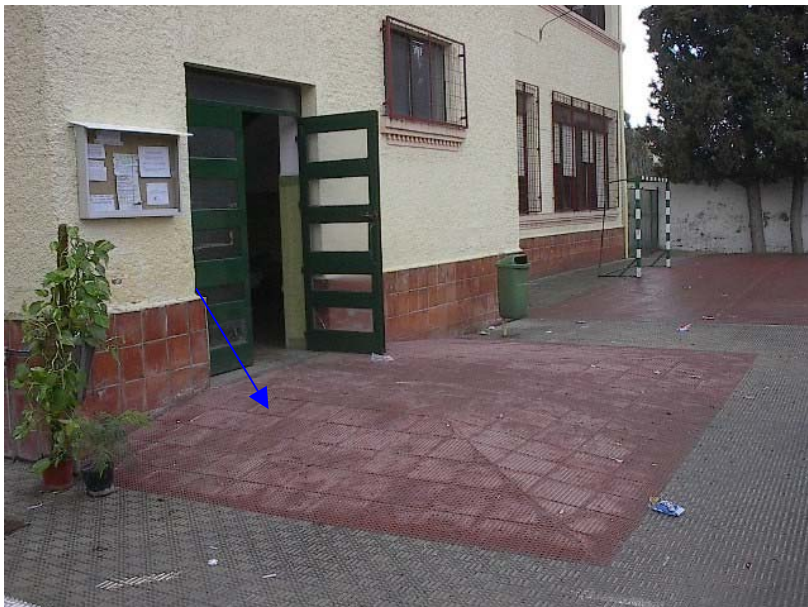
FOTO 3 | ENTRADA- RAMPA NO VÁLIDA- PENDIENTE EXCESIVA- SIN BARANDILLA
